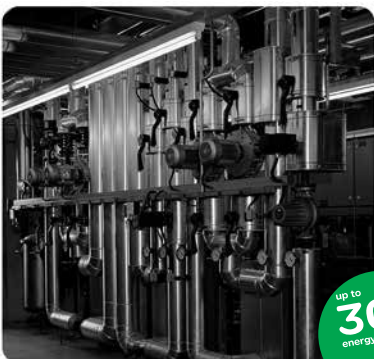
ATV 12 控制泵站 (▲)
