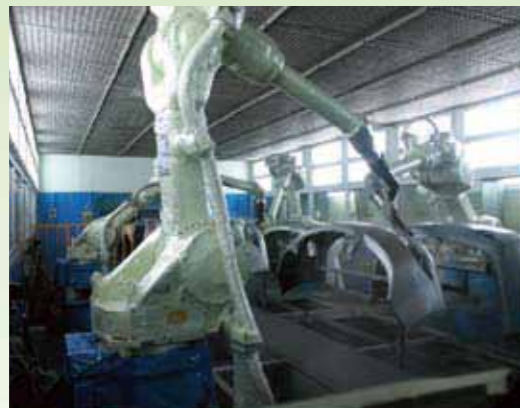
汽车保险杠喷涂生产线
