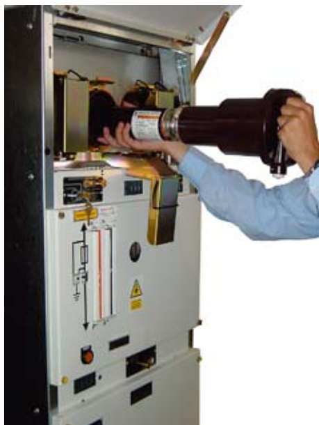
Fusarc CF 熔断器安装在CAS36柜中
